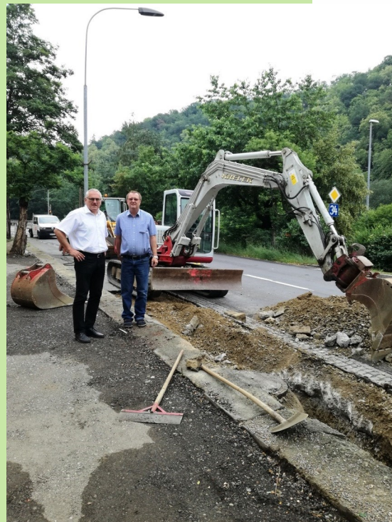
A1 Gemeindebeauftragter Paul Galuska und Bürgermeister Wolfgang Schmöger überzeugten sich im Sommer vom Baufortschritt bei den Grabungs- und Verlegearbeiten
